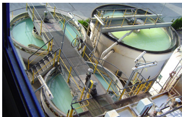
Planta de tratamiento de aguas físico-químico de Tarragona
